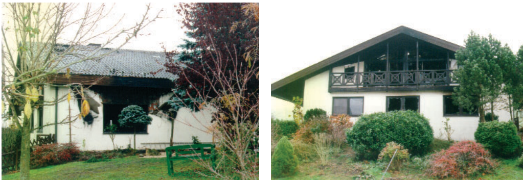
Abb. 17: Außenansichten des Brandobjektes nach dem Zimmerbrand
