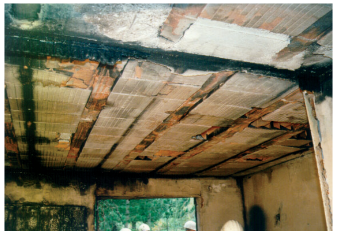
Abb. 16: Detailaufnahme der massiv ausgeführten Decke nach dem Verbrennen und Abfallen der Holzverkleidung [14]
