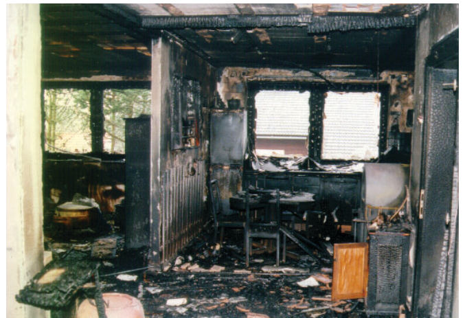
Abb. 15: Schadenbild eines Zimmerbrandes in einem Massivbau mit nachträglich angebrachter dekorativer Holzverkleidung [14]
